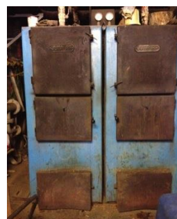
1.9b.att. Divi 0,3 MW katli Ērgemes katlu mājā
