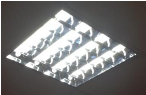
1.29a.att. Cauruļveida luminiscences spuldzes pašvaldības ēkā
