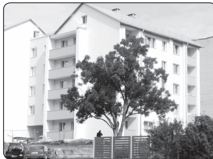
Lai gan vēl notiek pēdējie renovācijas darbi, māja jau tagad priecē ikvienu garāmgājēju un ir kā košs akcents apkārtējā vidē
